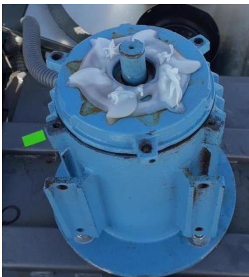
Рисунок 2 – Оплавившаяся крыльчатка охлаждения двигателя в результате перегрева подшипника при эксцентриситете ротора
